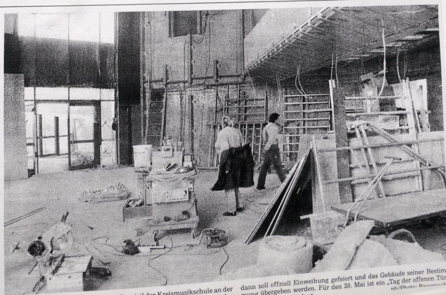
... haben die Handwerker im neuen Domizil der Kreismusikschule an der Freisinger Straße. Trotz des Trubels ist der Unterricht bereits wieder aufgenommen worden. Bis spätestens 19. Mai muß alles fertig sein, denn
